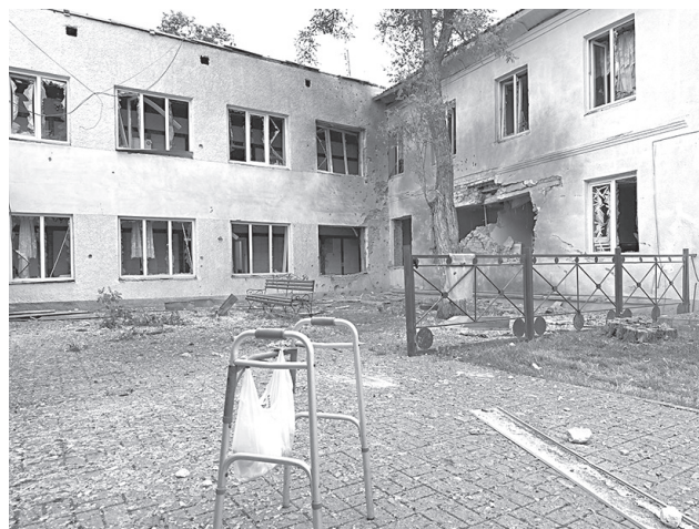
Разрушенный пункт ПВР
